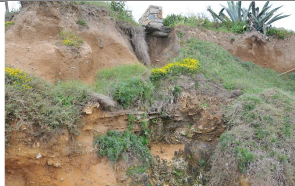
Foto 2. Spiaggia di Balai: effetti sui manufatti, dell'erosione regressiva al ciglio della scarpata
