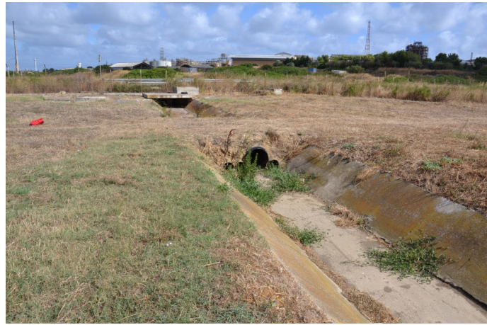
L'area a valle della discarica. Il tratto terminale adduce le acque ad un tombino assolutamente insufficiente a garantire lo smaltimento delle portate oggetto del presente studio
