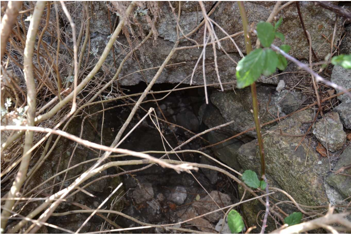
Particolare dell'ingresso del piccolo condotto realizzato sotto la strada documentata dall'immagine precedente
