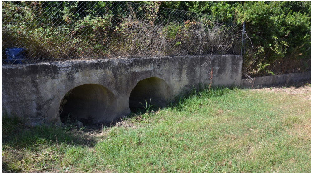
Il tombino, costituito da due tubolari di 100 cm di diametro, posto sotto il rilevato della provinciale, assolutamente insufficiente a garantire lo smaltimento delle portate oggetto del presente studio
