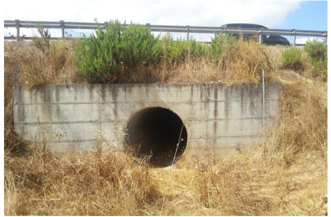
Il tombino posto in corrispondenza della intersezione dell'asta fluviale con la strada per Stintino.
